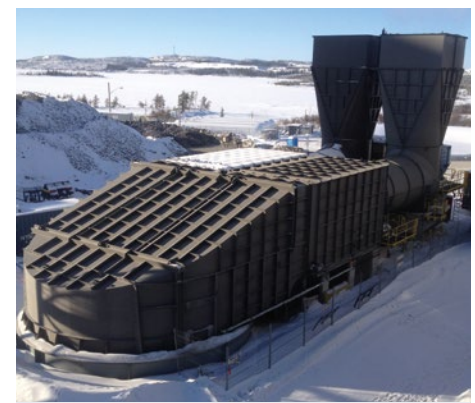
Primary exhaust fan
