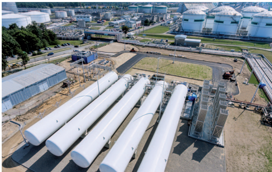
LNG přijímací terminál po jeho dokončení
