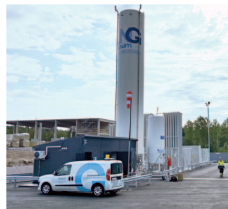
LNG LCNG čerpací stanice ve Finsku, 2017
