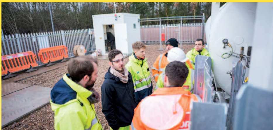
Calorgas, LNG plnicí stanice v UL
